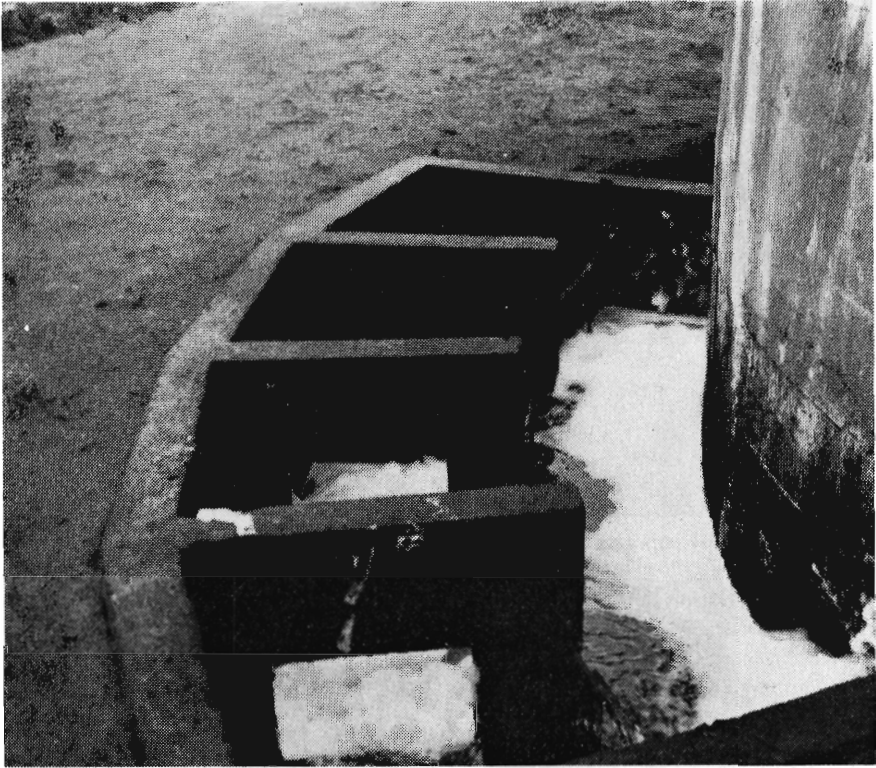
Fordelingsbygværket ved afløbet fra det biologiske filter i Vammen. Det iltholdige vand fra filtret fordeles til de to forklaringsbassiner og til efterklaringsbassinet. Den herved frembragte cirkulation gennem bassinerne med iltholdigt vand forhindrer dårlig lugt fra rensningsanlægget og forbereder den biologiske rensning på stenfiltret.
