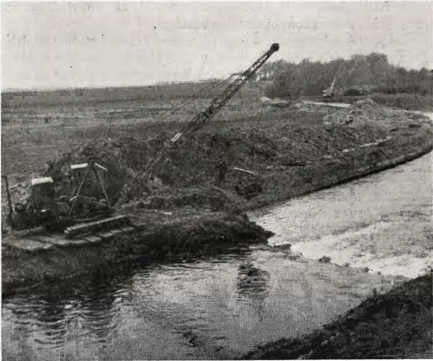
Odense å: Arbejdet med udvidelsen af åens profil er igang ca. 1½ km ovenfor Borreby.
