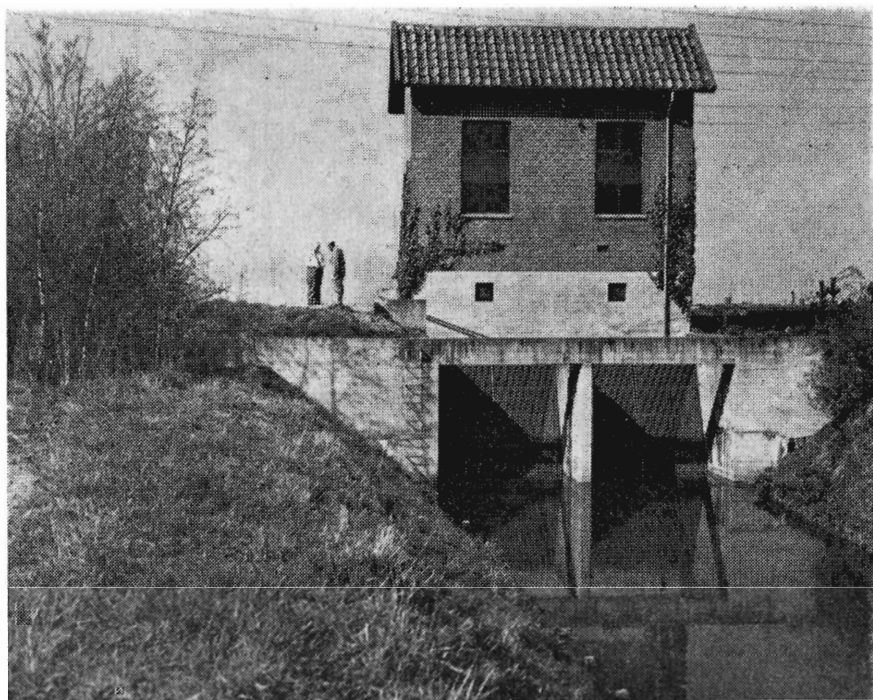
Automatisk elektrisk pumpestation på Orebygaard. Pumpen pumper fra afvandingskanalen vandet op i fuglereservatet Fladet.
