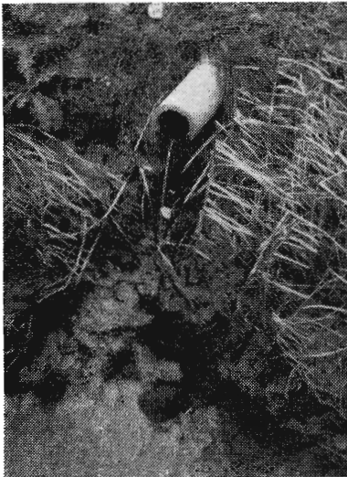
Underskyttet drænudløb, hvor vandstrømmen er begyndt at erodere i skråningen.
