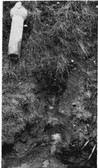
Dårligt drænudløb, der oprindeligt var etableret med et tungt udløbsrør af cement, som jorden ikke kunne bære.
