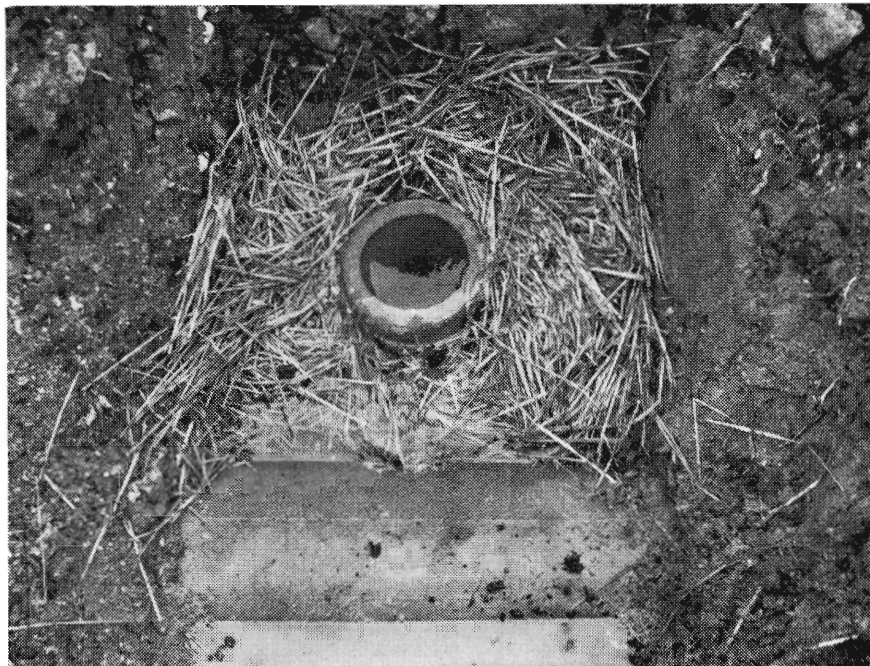
Fig. 5: Et lodret trykvandsdræn, der er ført ned til en dybde af ca. 4 m under terræn. Vandføringen er ca. 1,5 l/sec.
