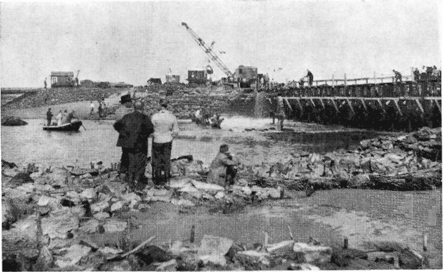
Fig. 4. Afslutningsdiget set fra fjordsiden. Man ser arbejderne stå i vandet med store træflager for at få det indpumpede sand til at lejre sig efter ønske. Vandstrømmen gennem diget er nu så at sige stoppet. Klokken er ca. 11, og de implicerede parter har fået lykønsket hinanden med den veloverståede lukning af diget.
