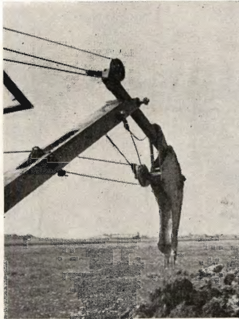
Ved dræningsarbejder udstyres grave-maskinen med en særlig formet skovl, som vist ovenfor. Arbejdsbredde 28 cm.
