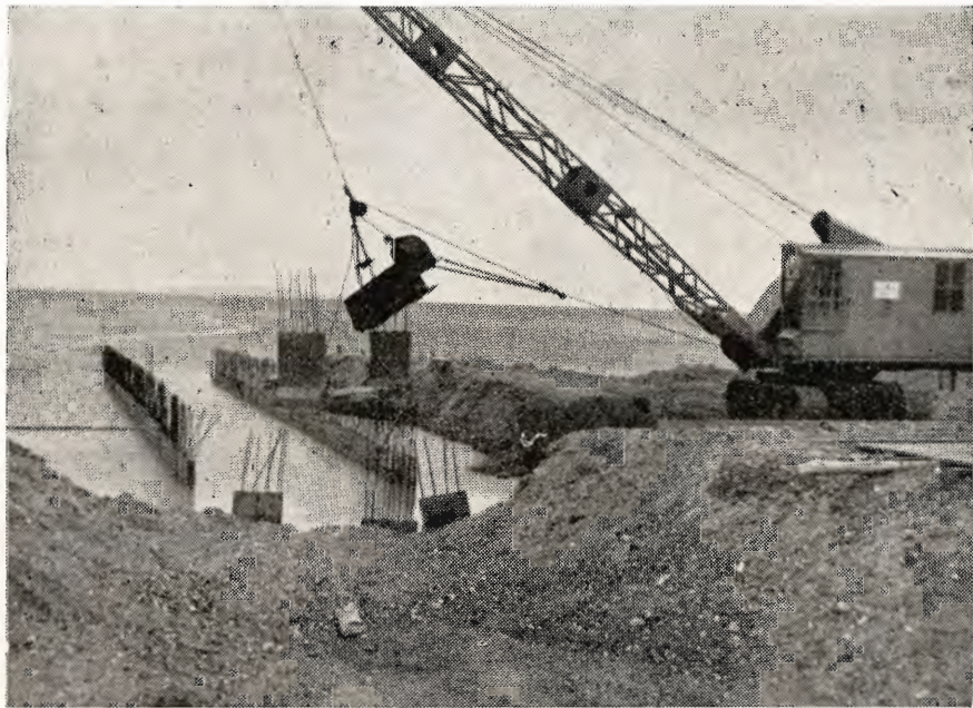
Udløbsbygværk ved Bjørnsholm kanalens udmunding i Limfjorden under udførelse. En kran udlægger prefabrikerede betonelementer på den regulerede fjordbund. Senere støbes elementerne sammen ved hjælp af to langsgående bjælker (hamre).
