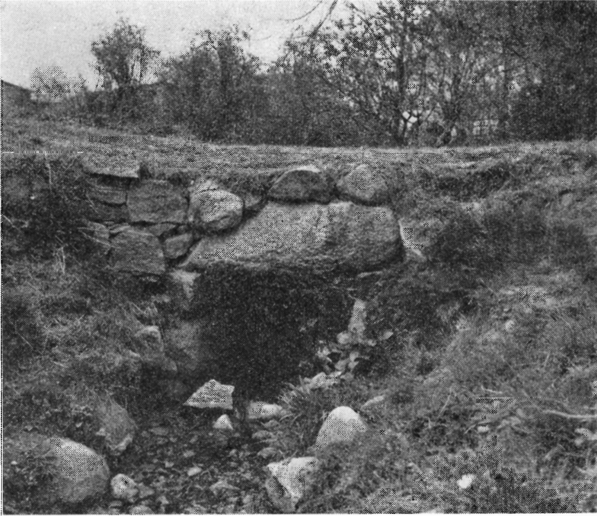
Gammel Vejbro, der forsvinder, fordi vejvæsenet omlægger vejen samtidig med at vandløbet uddybes.
