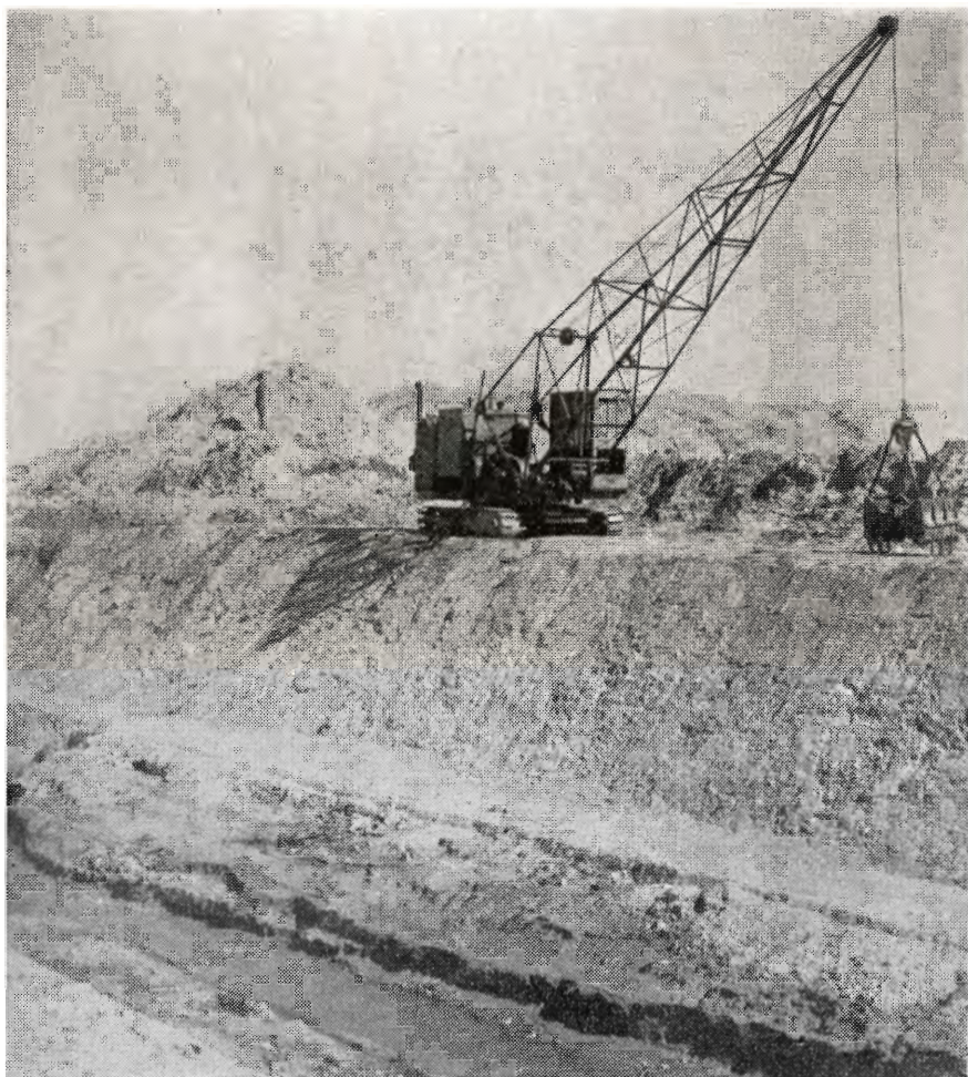
Udgravning gennem højt terræn af afvandingskanal for at kunne gennemføre afvandningen af Skinkelsø og Hagerup sø ved Frederikssund. Ved afvandningen indvindes ca. 300 ha.
