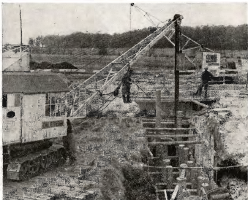
Etablering af nyt underløb under hovedvej 16. Rørene i udløbssiden er nedlagt og billedet viser ramning af fun- deringspæle under 2. halvdel af vejdæmningen. Fot. J. C. P.
