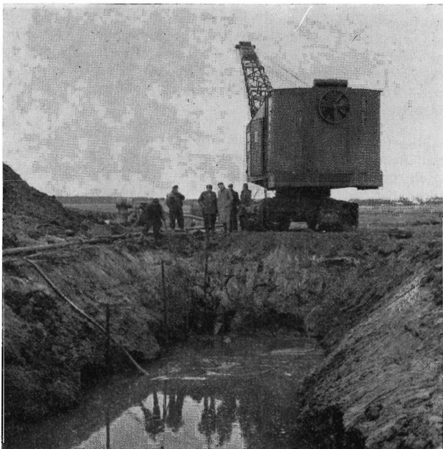
I november 1962 gennemførtes udgravningerne under ret vanskelige forhold til en stor rørledning, der skal føre oplandsvandet fra nordsiden af Skjernåen mellem Albæk og Borris under den nye Skjernå til den sydlige parallelkanal. Der måtte her anvendes sugespidsanlæg for at holde udgravningen tør.
