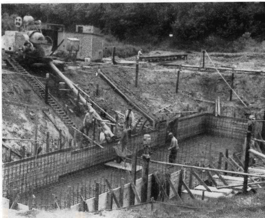
Fig. 4. Fundamenterne til sluse- og pumpeanlægget er under udførelse. Armeringen og forskallingen for den dybeste betonbund er anbragt. Byggegruben holdes tørlagt ved hjælp af en række borer, som på billedet ses anbragt i byggegrubens skråningssider. Den særlige metode til tørlægning af byggegruben blev valgt, fordi jordbunden bestod af flydesand.
