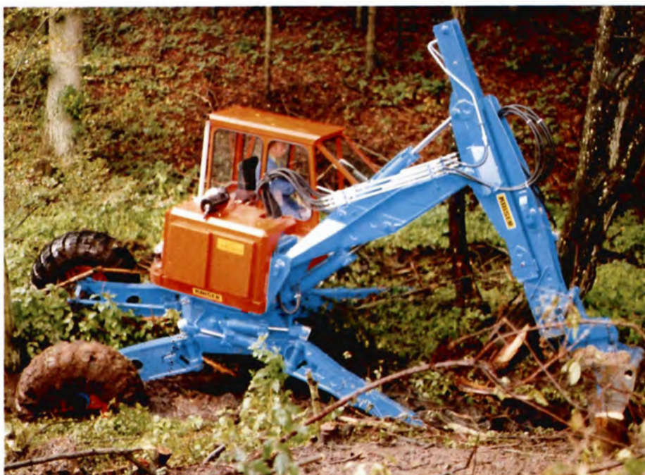
Figur 3. Oprensning med "Gyngemosens" Kaiser gravemaskine.
