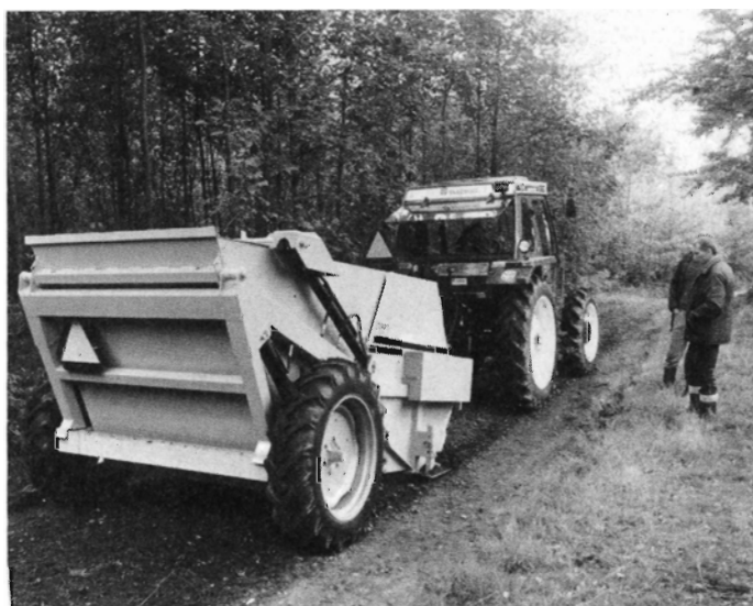
Figur 4. Stensamler, som river vejbanen op, sorterer materialet og lægger det ud igen (Saga/Havemose).
