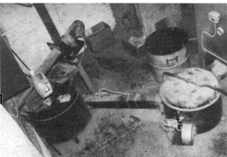
Fig. 3. Fyrrummet på godsets hovedbygning med forfyret og kedel til højre i billedet.
