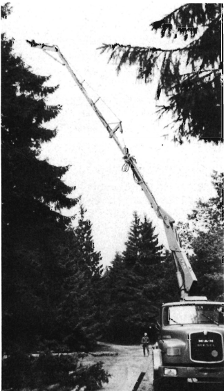
Fig. 1. Topkappingsudstyr bestående af en M.A.N. lastvogn (type 12230) med Lyka kran (7 t/m). Foto: Børges Foto, Karup.
